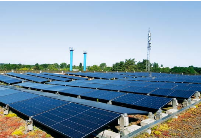
Auf dem Dach des Parkhauses Friedenstal in Bernau erzeugen 720 Solarmodule Strom zum Teil zur Eigenversorgung.
