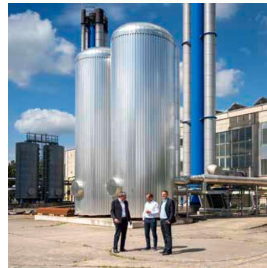
Das BHKW Schönfelder Weg in Bernau ist eine der effizienten KWK-Anlagen der Stadtwerke Bernau, in denen Energie für den Barnim entsteht.
